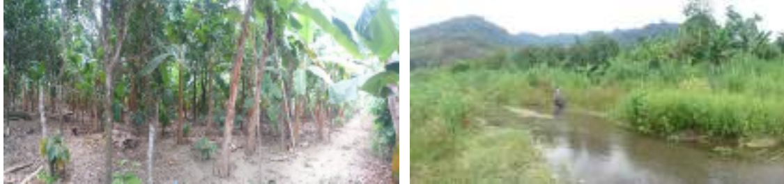
Fotografía 21.1- 34 Sitio de construcción de la PTAR Chirijos y su punto de descarga.
