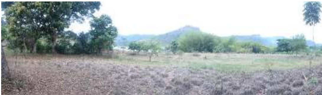
Fotografía 21.1- 33 Sitio de construcción de la Planta de Tratamiento de Agua Potable en Mancha Grande
